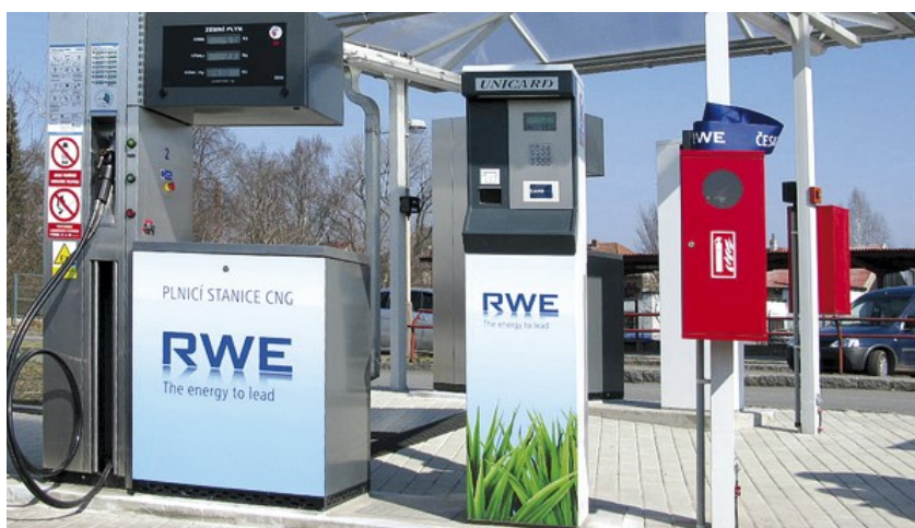
Obr. 8 Plnicí stanice CNG
