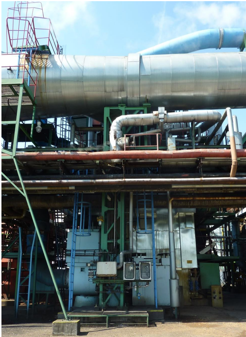
Obr. 1 Vodotrubný kotol umiestnený v chemickej prevádzke.
