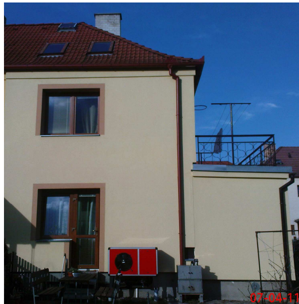
Obrázek 32 Pohled na dům ze západní strany s instalací tepelného čerpadla
