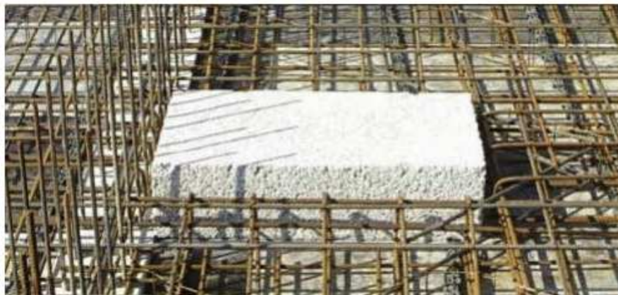
Obrázok J.4 - Príklad uloženia Safety blocku v mieste prestupu v stropnej konštrukcii [61]
