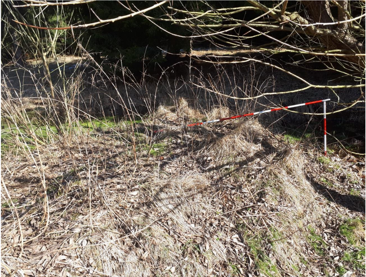
Obr. 79: ZSV Bohdalůvka. Rybník. Koruna hráze dosahuje šířky 2 m, výška u výpustě 80 cm (foto: V. Kolomazníček, 2015).
