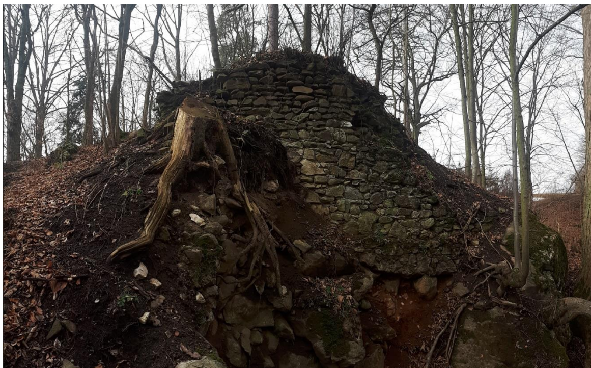
Obr. 64: Relikty kamenné zdi hradu Holštejna zachované na severovýchodní straně vstupní plošiny (foto: V. Kolomazníček, 2019).
