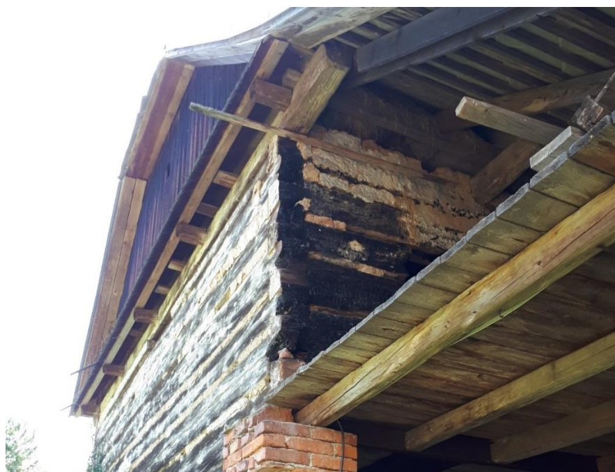
Obr. 71: Holštejn. Stopy po požáru Dolního mlýna v severovýchodním nároží hospodářského traktu (foto: V. Kolomazníček, 2018).
