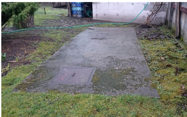
Obr. 11 – Ukázka stávající bezodtokové jímky
