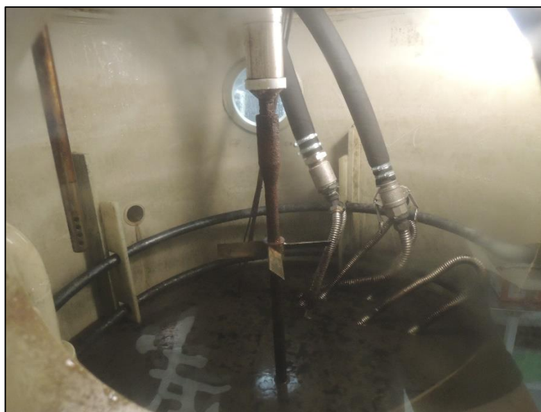
obr. 57: Uložení vlnocového výměníku pro ohřev fugátu uvnitř ohřevné nádrže.
