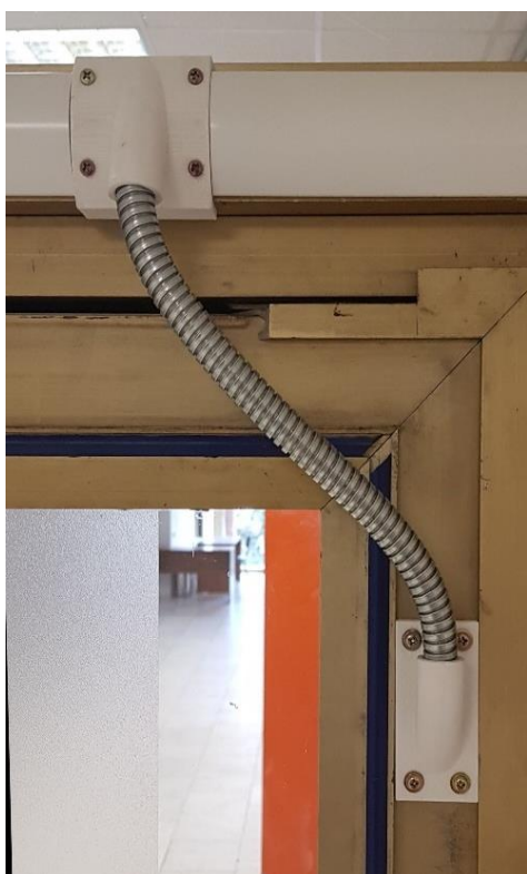
Obrázek 107 – Kabelové vedení – zavřeno. Zdroj: vlastní.
