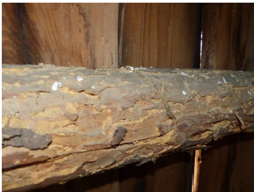
Obr. 24: Napadení štítové vazby tesaříkem krovovým.
