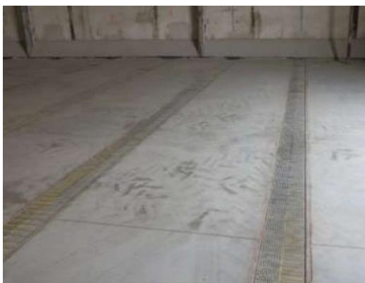
Obrázek 7: Přejezdné provzdušňovací rošty [23]
