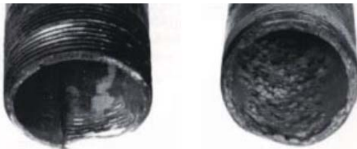
Obr. 19 Poškození potrubí kyselinou uhličitou (vlevo) a pittingem (vpravo)
