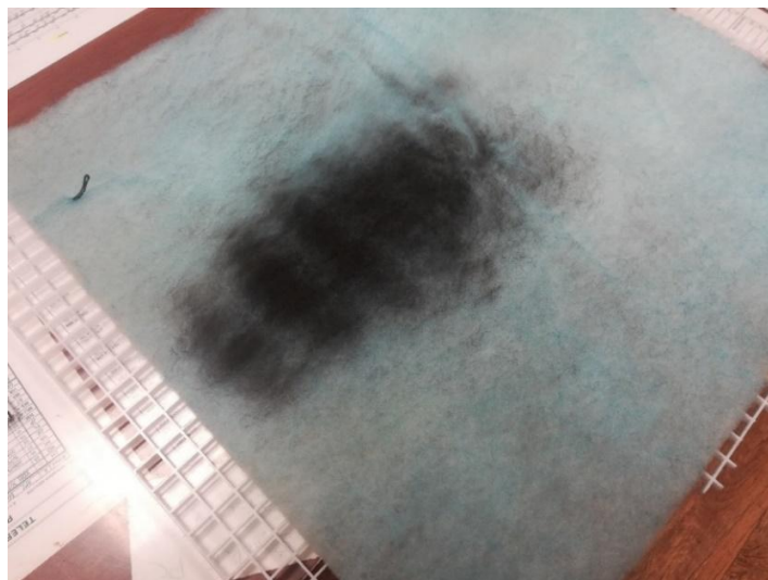
Obr. 36 - Fotografie filtru v místnosti dozorčího SPO po jednom měsíci použití
