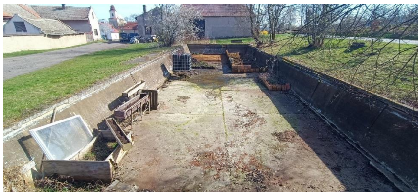
Foto 36: Nádrž v havarijním stavu (Formánek, 2024)
