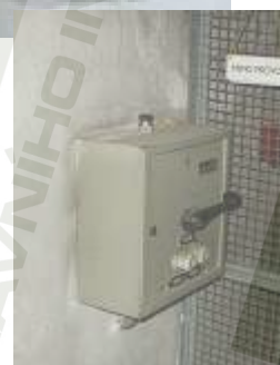
Obr. 3. – Rozvaděč a hlavní vypínač
