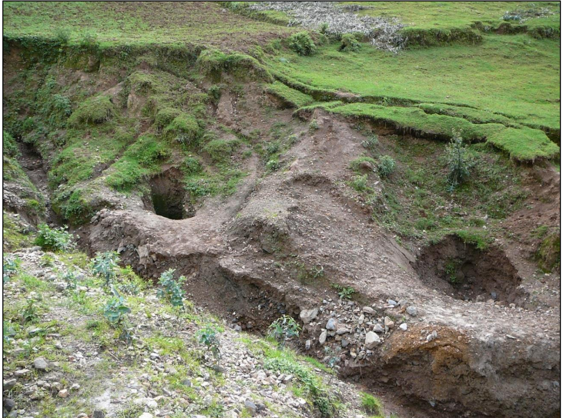
Obrázek 42: Svah narušený svahovými procesy
