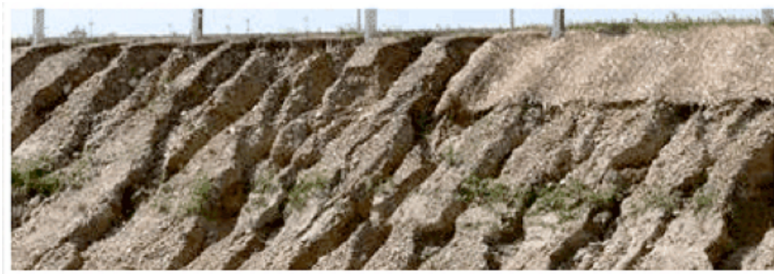
Obr. 1: Erozní rýhy po přívalemých deštích, vpravo nevhodně zvolená protierozní ochrana (Geomat, 2017)
