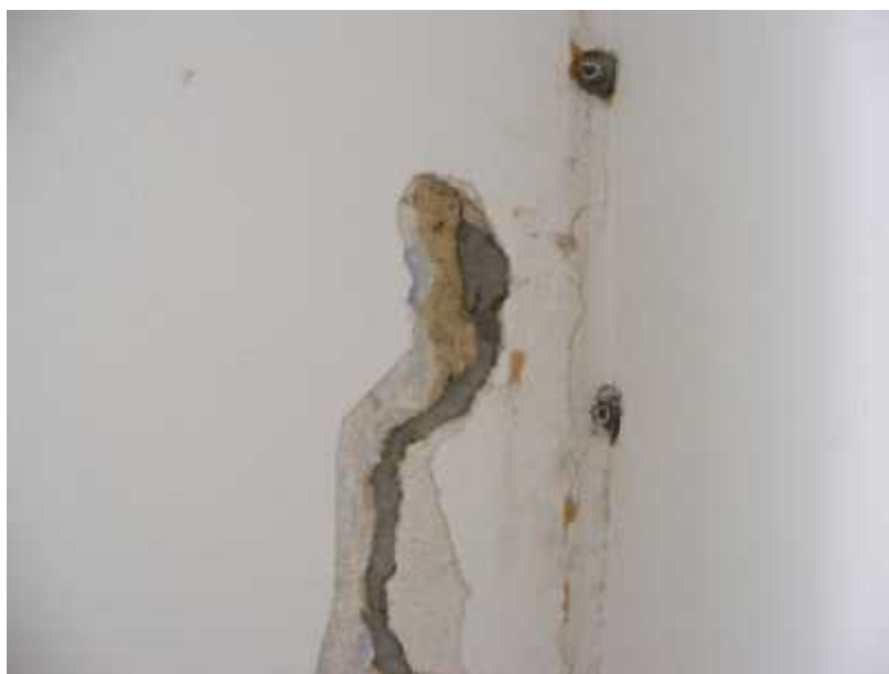
Obr. č. 67 –injektovaná trhlina
