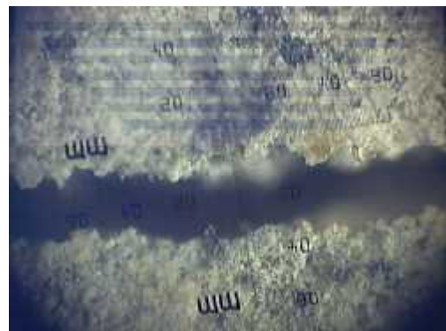
Obr. č. 24 – pohled na trhlinu mikroskopem
