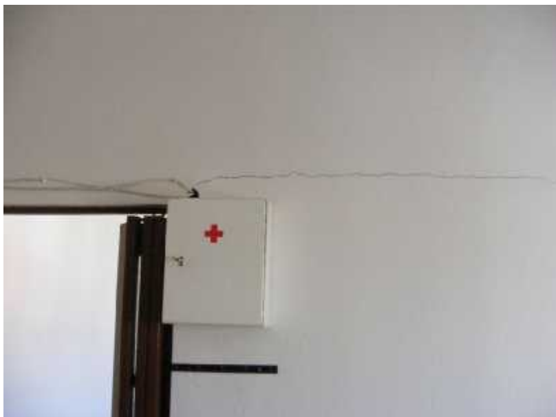
Obr. č. 63 – trhlina ve stěně
