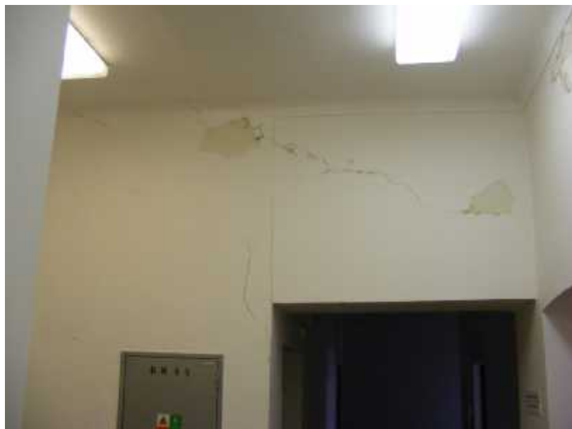
Obr. č. 48 – trhliny v překlade
