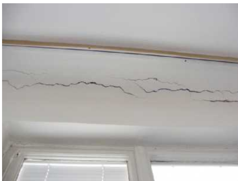
Obr. č. 65 – trhliny ve stropě
