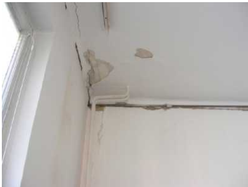
Obr. č. 64 – trhliny v rohu
