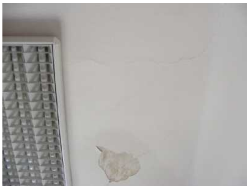
Obr. č. 75 – odlup na stropě
