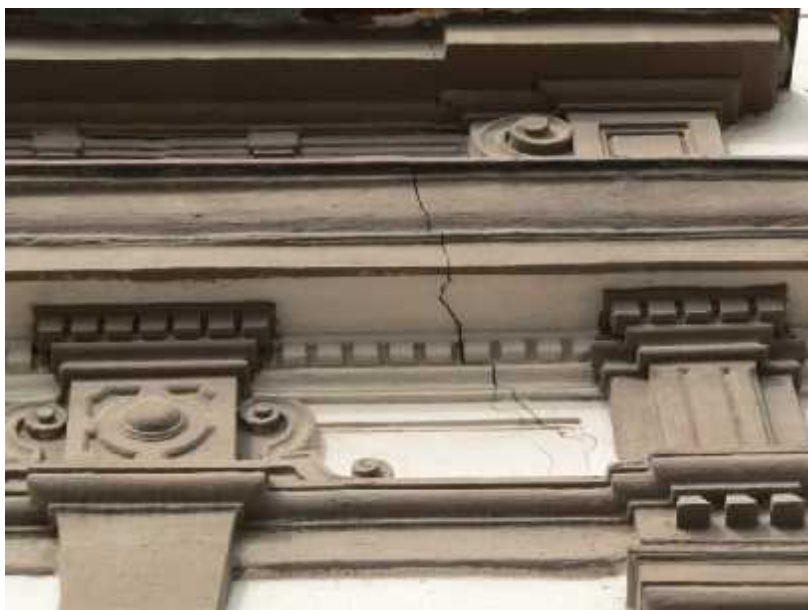
Obr. č. 82 - trhlina
