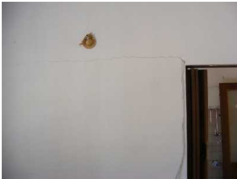
Obr. č. 60 – trhlina ve stěně
