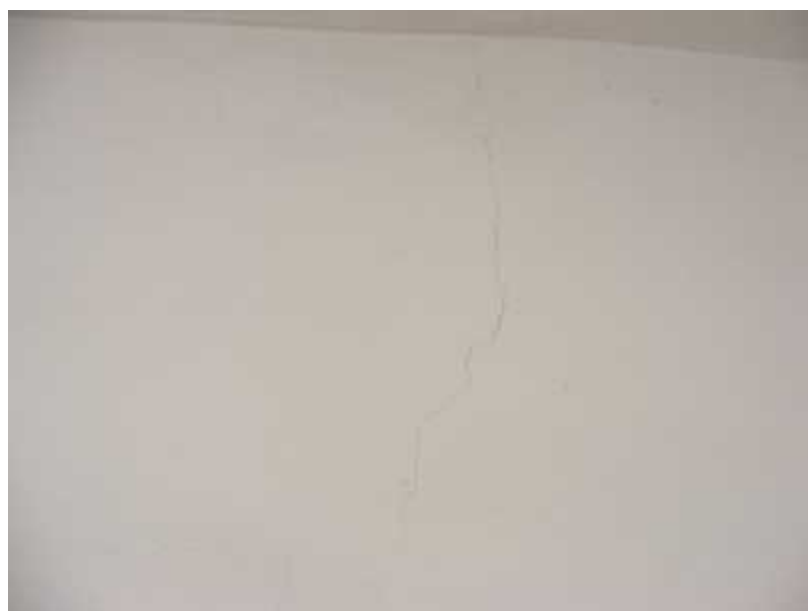
Obr. č.42 - prasklina
