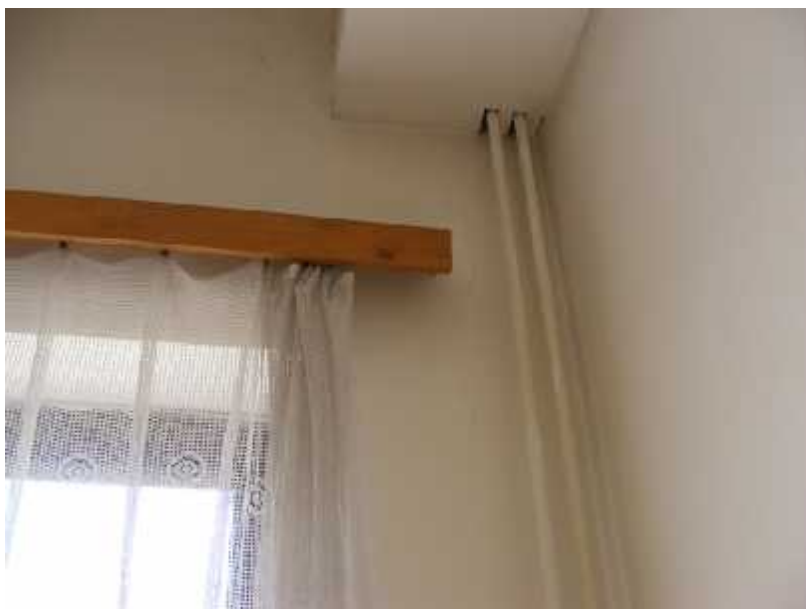
Obr. č. 56 – trhlina u okna
