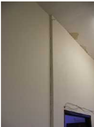
Obr. č. 54 – trhlina ve spoji SDK a zdiva
