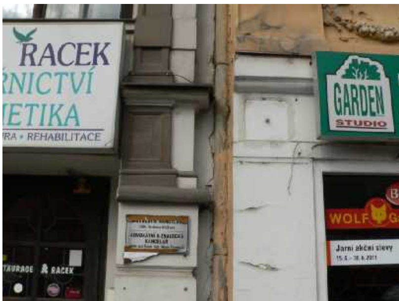
Obr. č. 83 – trhlina ve styku se sousedním objektem
