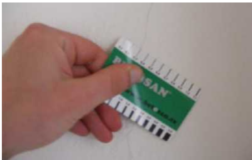
Obr. č. 45 – měření trhliny
