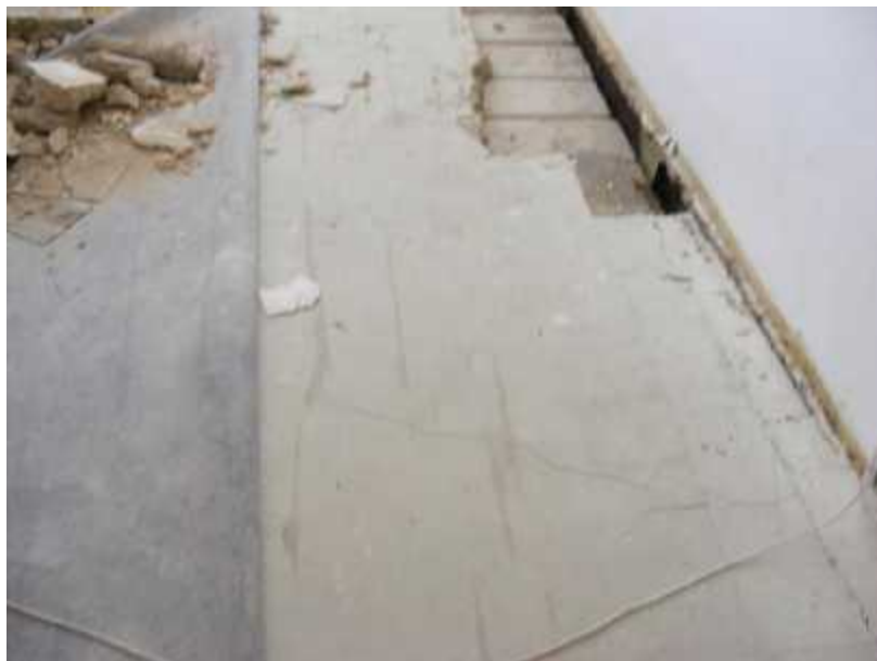
Obr. č. 68 – propadená podlaha
