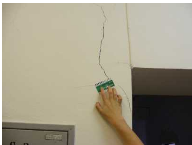
Obr. č. 49 – měření šířky trhliny
