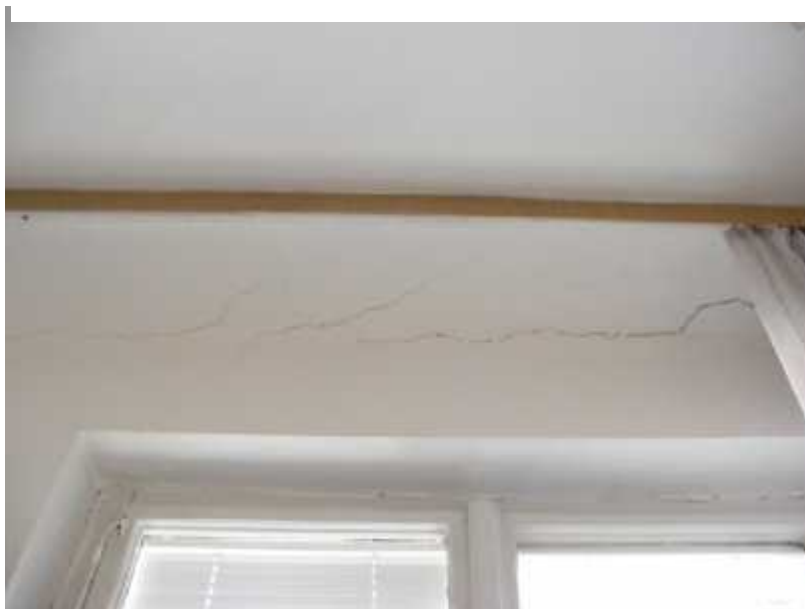
Obr. č 61 – trhlina v překladu
