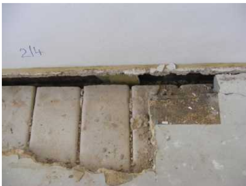
Obr. č. 69 – detail propadené podlahy
