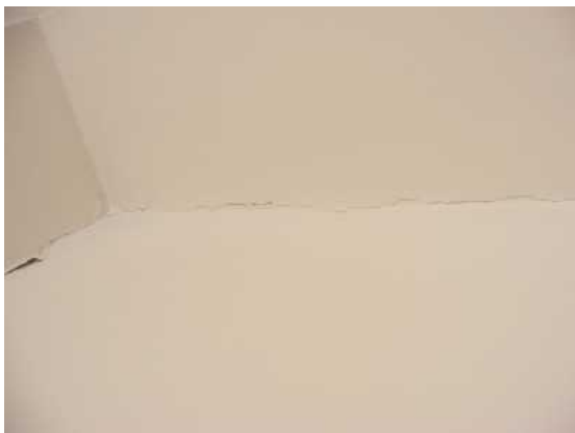
Obr. č. 57 – trhlina ve výklenku
