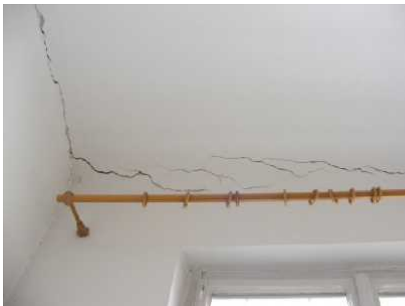
Obr. č. 66 – trhliny ve stropě
