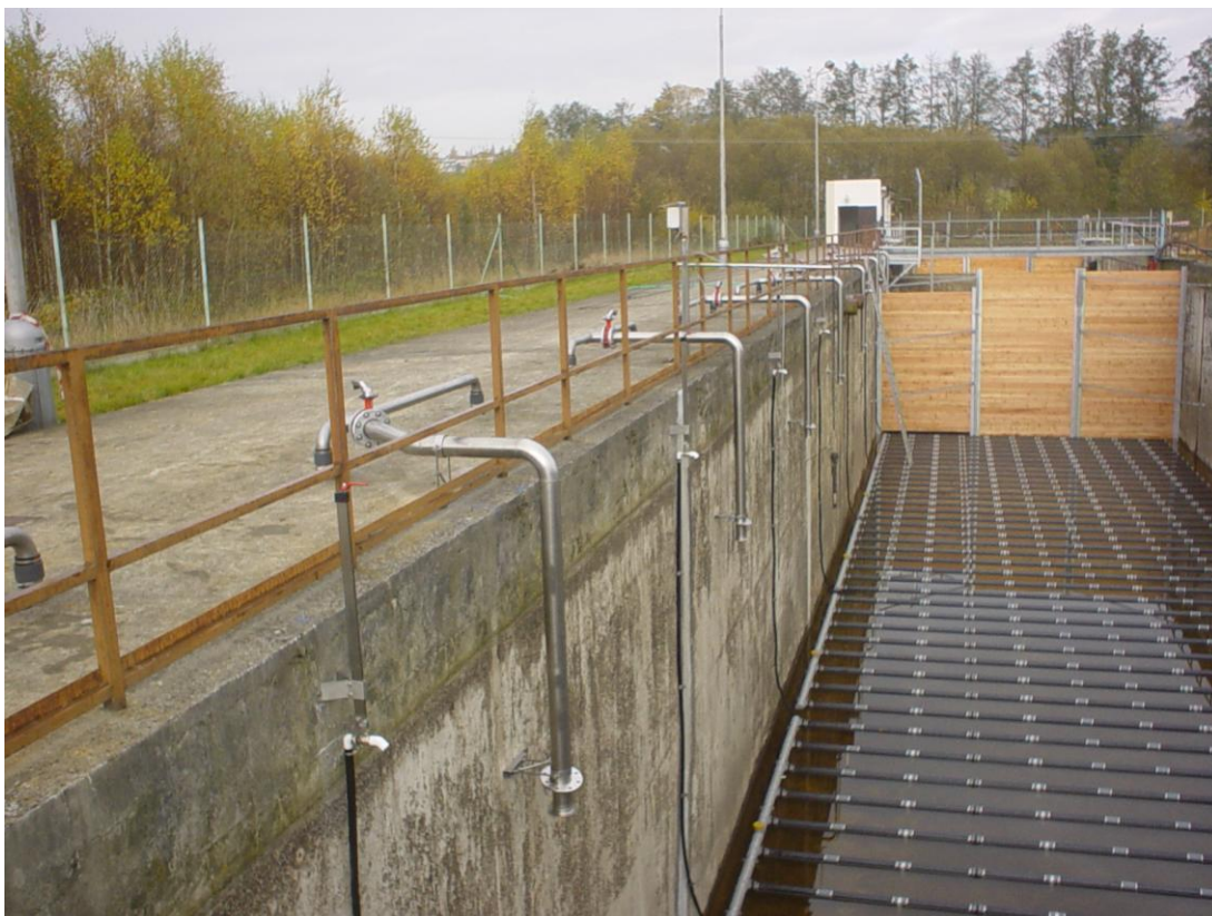
Obrázek 8: ČOV Tachov po rekonstrukci – aktivační nádrž (foto: P.Ivanovská)
