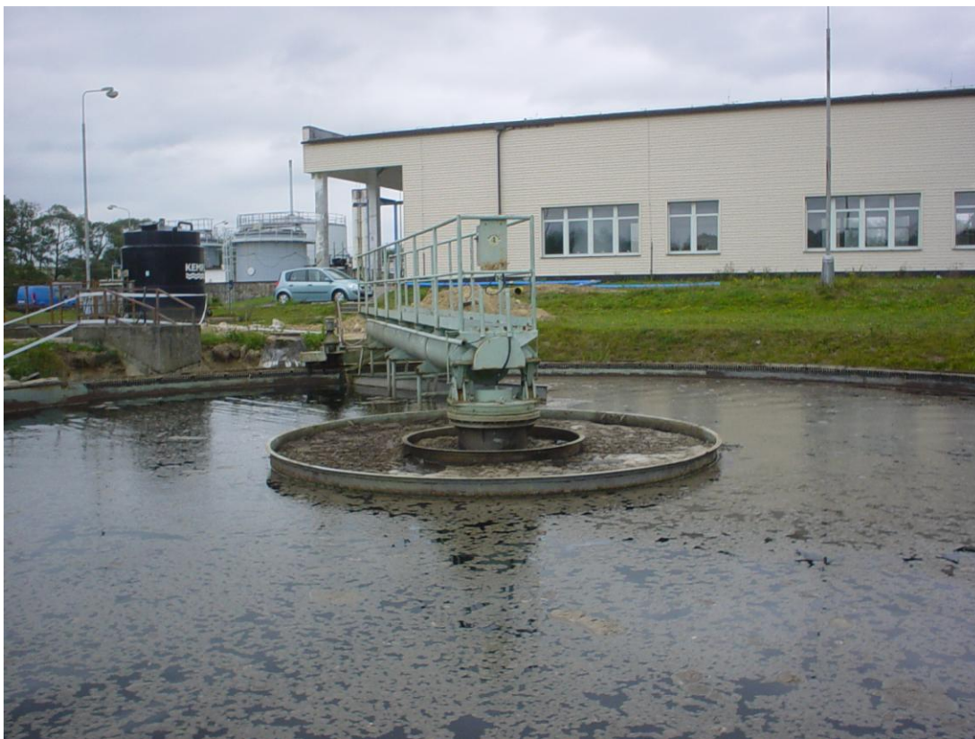
Obrázek 6: ČOV Tachov před rekonstrukcí – dosazovací nádrž (foto: P.Ivanovská)
