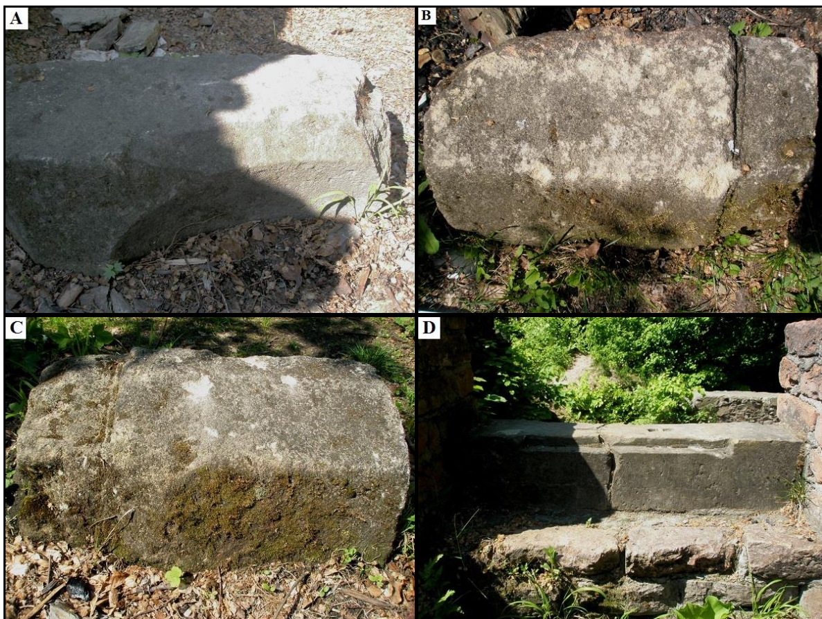
Obr. 6 A – zlomenný blok z okenního/dveřního oblouku zhotovený z hrubozrnného pískovce; B, C – opracované kamenné bloky hrubozrnného pískovce; D – okenní římsa zhotovená z jemnozrnného pískovce
