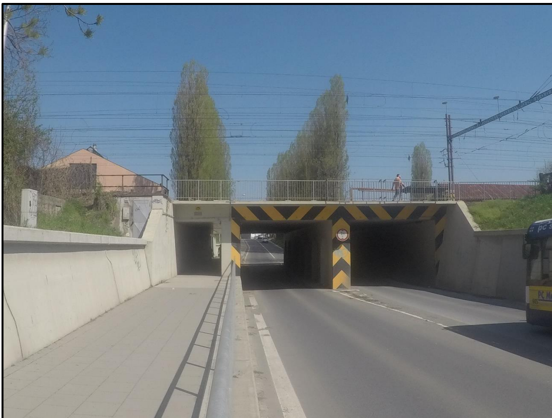
Obr. 3. Železniční podjezd z ulice Pasteurova do ul. U Podjezdu. Místo, se zvýšeným výskytem cyklistů na chodníku a místo, které lidé vnímají jako nebezpečné
