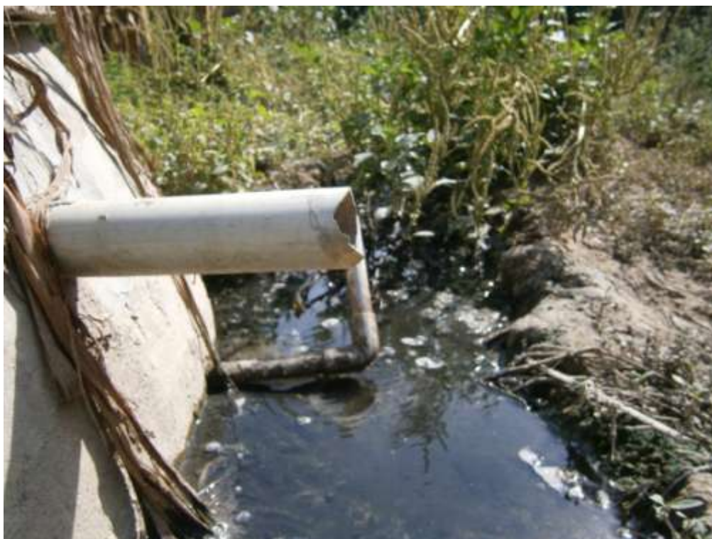
Obr10: Výtok tekutého digestátu z rezervoáru
