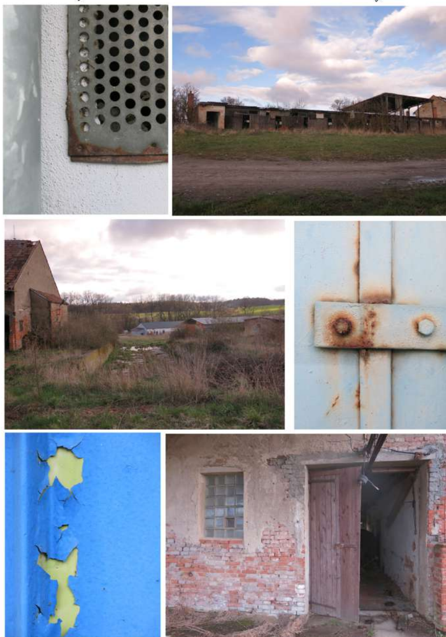
Obrázek 14 – fotodokumentace budov v destrukci, K. Zelená
