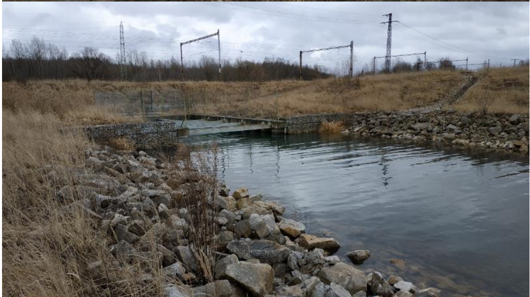
Příloha 47: Jímací objekt pro manipulaci s vodou z řeky Ohře.
