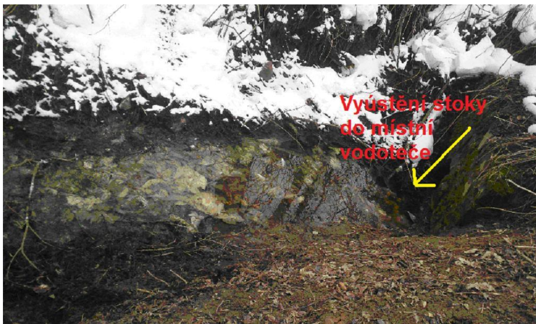
Obrázek č. 30: Vyústění dešťové stoky do drobné vodoteče na p. p. č. 1328/1. (foto vlastní)
