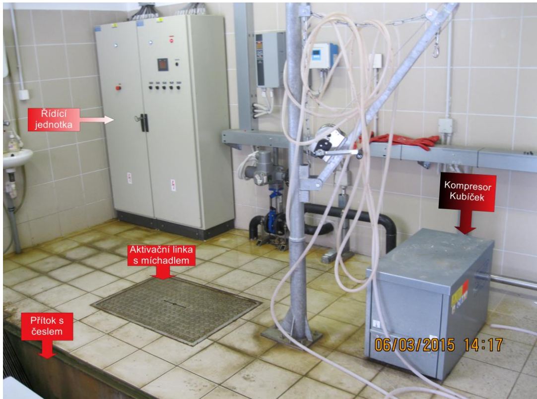
Obrázek č. 22: Provozní objekt ČOV Mnichov s aktivací (foto vlastní)
