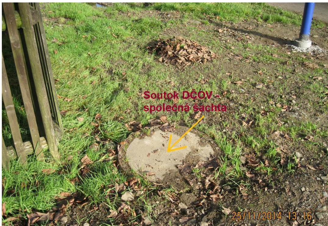
Obrázek č. 32: Šachta – soutok DČOV před vstupem do dešťové kanalizace. (foto vlastní)
