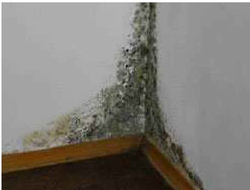
Obrázek 6.1 – 1 – Na místech tepelného most se tvoří typická plíseň [11]
