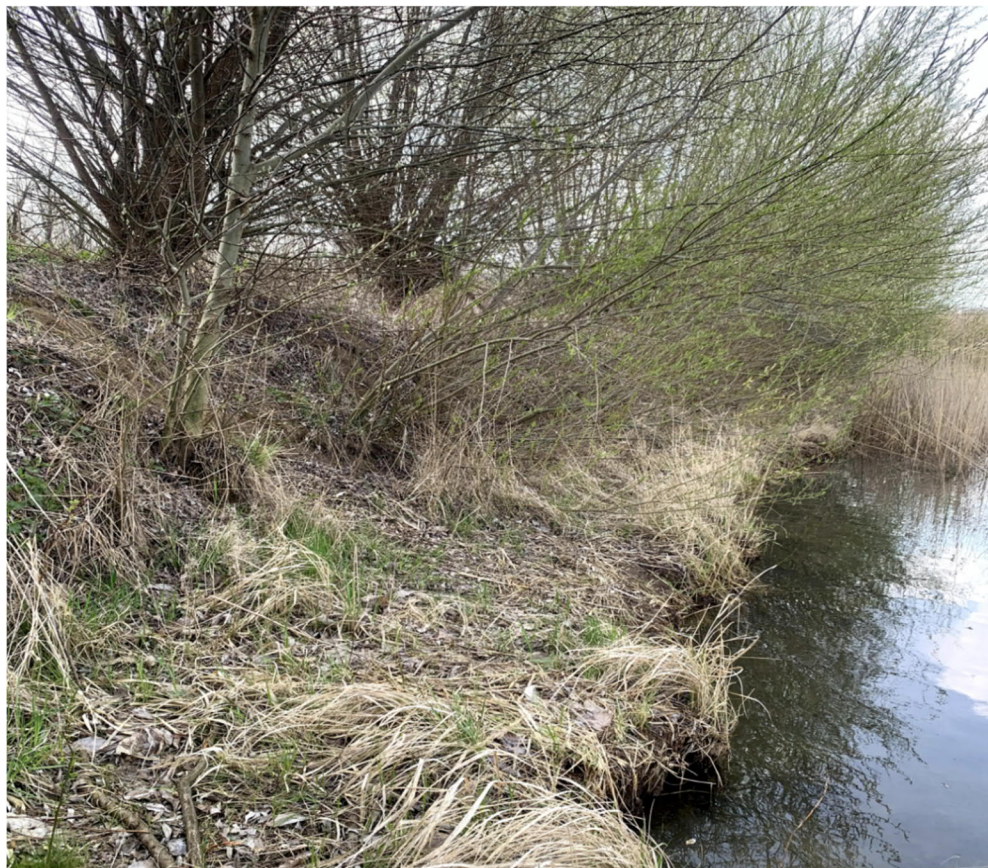
Obrázek 14 – Abrazní srub úseku B [20]
