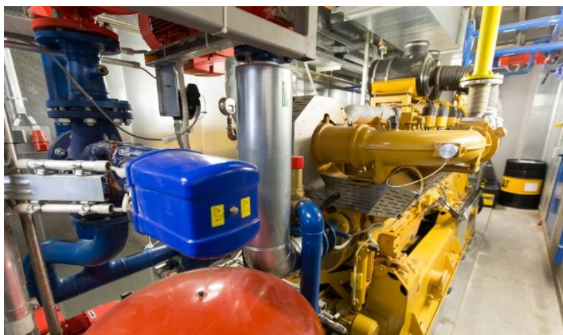
Obr. 2.14 Kogeneračná jednotka Zdroj: Vlastné spracovanie.
