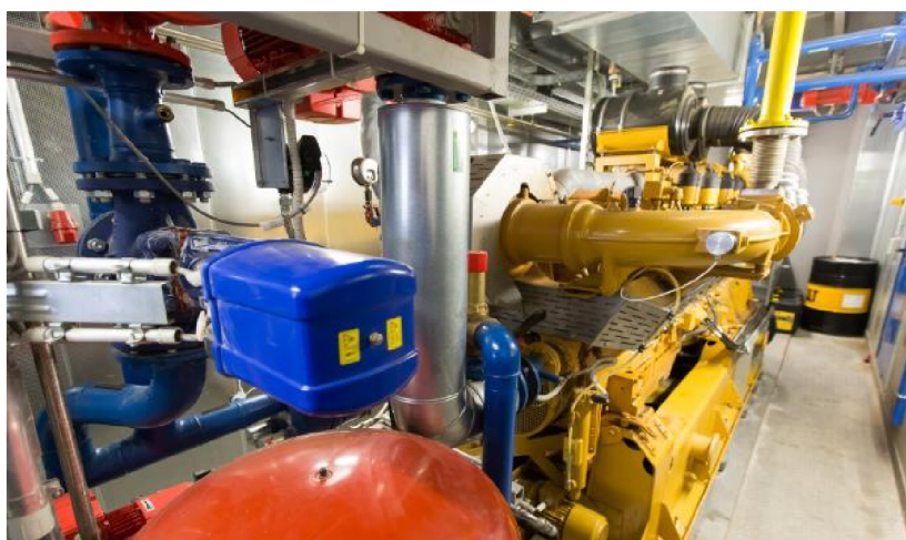
Obr. 2.14 Kogeneračná jednotka Zdroj: Vlastné spracovanie.
