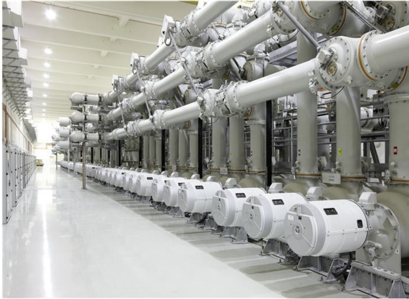
Obr. 34) Zapouzdřená plynem izolovaná rozvodna VVN [43]
