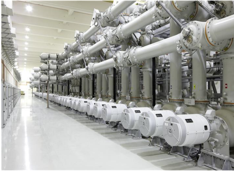
Obr. 34) Zapouzdřená plynem izolovaná rozvodna VVN [43]
