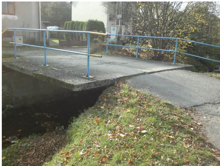
Obr. 2: Špatný technický stav mostu v Březnici
