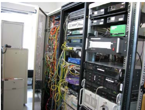
Obr. č. 25: Servery HZS JčK
