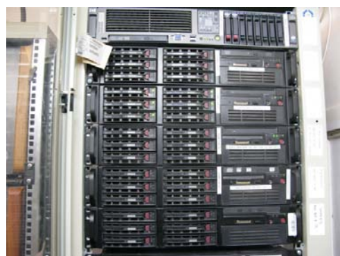
Obr. č. 26: Servery HZS JčK
