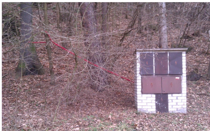
Foto 23 Rozvod elektřiny v rekreační chatové osadě (Krinedlová, D. 2013)
