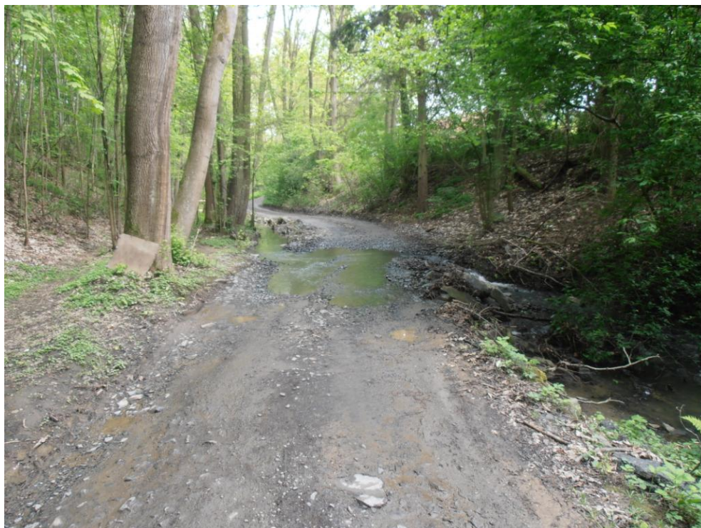
Obr. č. 31: Nekvalitní příjezdová komunikace ST26B8 Koníček
