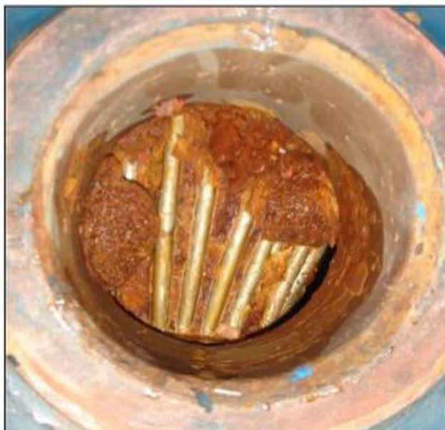
Obr. 12 Poškozený výměník korozí a usazeninami [8]
