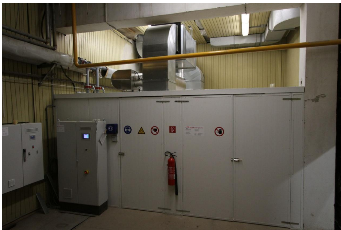
Obrázek 3.2 Kogenerační jednotka na rostlinný olej v provedení s odhlučňovou strojovnou
