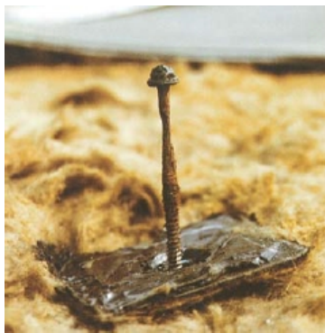
Obr. 32: Poškození kotevního prvku korozí [17]
