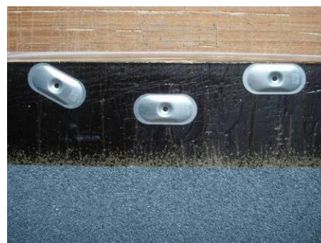
Obr. 49: Nepřípustné umístění kotevních prvků
