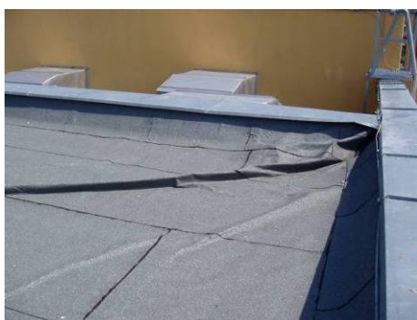
Obr. 46: Selhání kotevního systému povlakové hydroizolační vrstvy [84]
