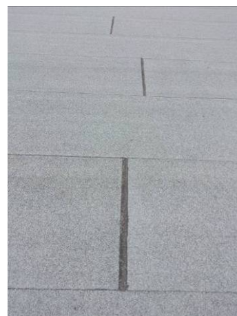
Obr. 45: Usmýknutí příčných spojů na střeše
