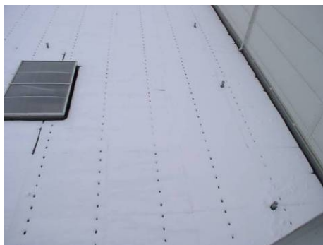
Obr. 40: Viditelné tepelné mosty v místě kotevnických prvků [84]
