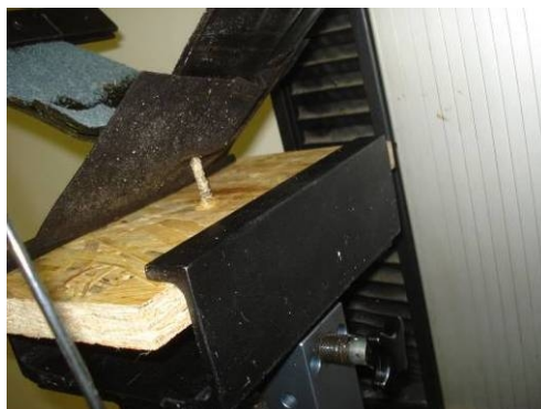
Obr. 105: Vytržení kotevního prvku z podkladu
