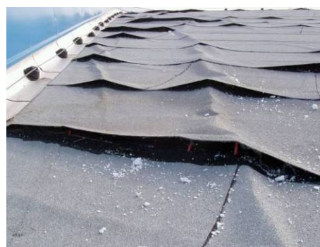
Obr. 47: Selhání kotevního systému povlakové hydroizolační vrstvy [84]
