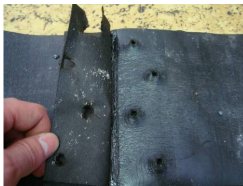
Obr. 162: Asfaltový pás po vytržení všech hřebíků
