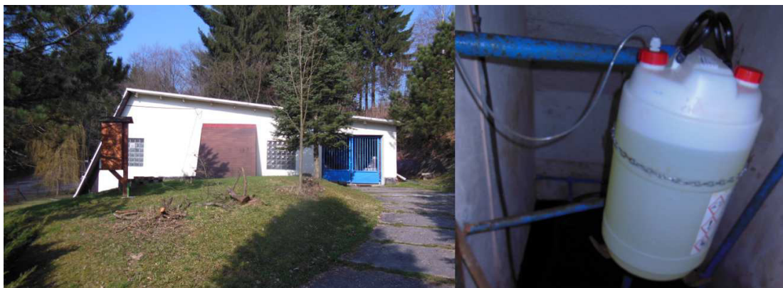
Obr. 2.4 Úpravna vody v Kateřinicích, barel s chlornanem sodným
