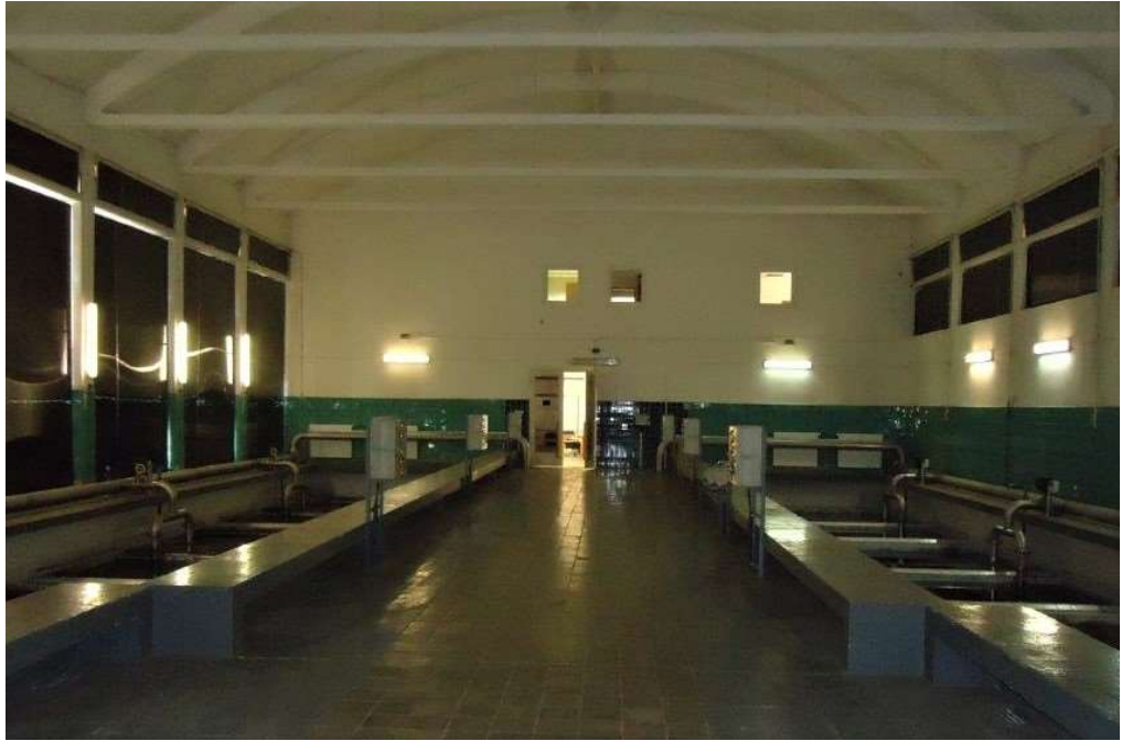
Obr. č. 9: Pískové filtry v úpravně vody Klíčava (autor, 2020)
