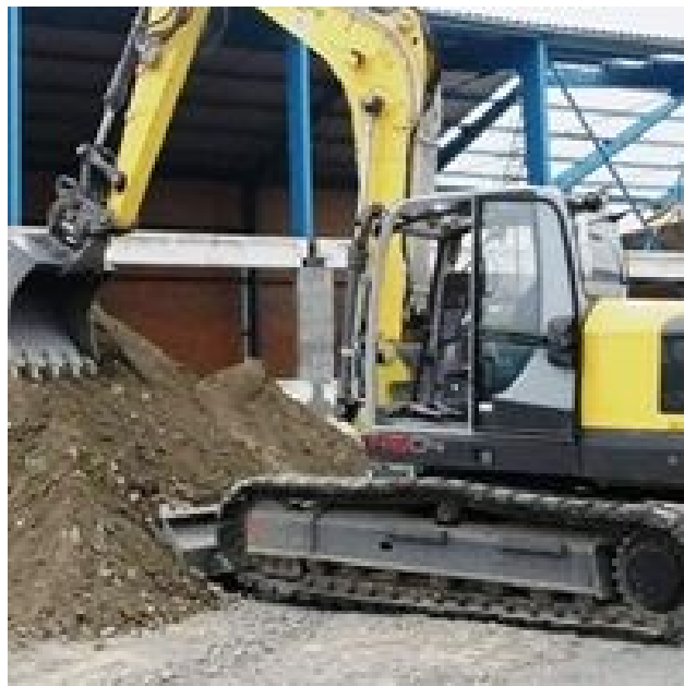
Obr. 8 Uložiště stavebního odpadu. Zdroj vlastní.
