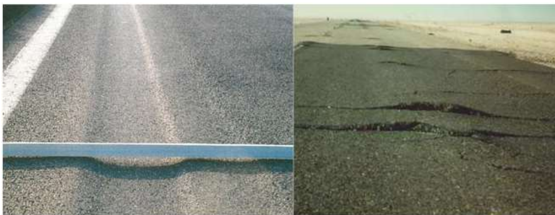
Obrázek 8: (a) vyjeté koleje, (b) mrazové trhliny [33]
