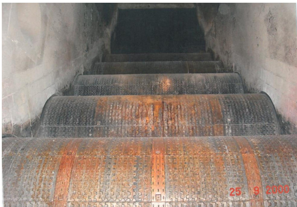
Příloha č. 5 - Fotografie původního válcového roštu (SAKO Brno, a.s., 2016)
