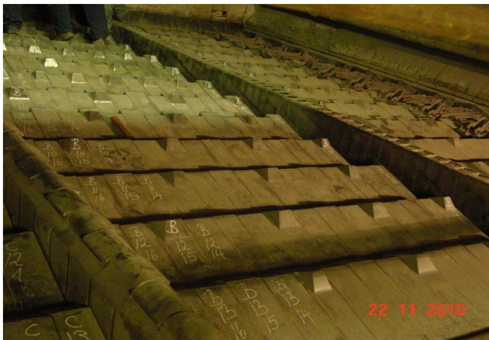
Příloha č. 6 - Fotografie současného vratisuvného roštu (SAKO Brno, a.s., 2016)
