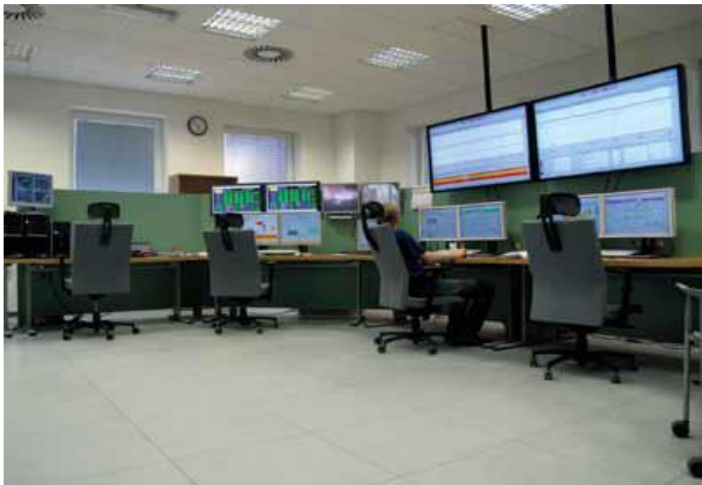
Příloha č. 4 - Fotografie velín po rekonstrukci (SAKO Brno, a.s., 2016)
