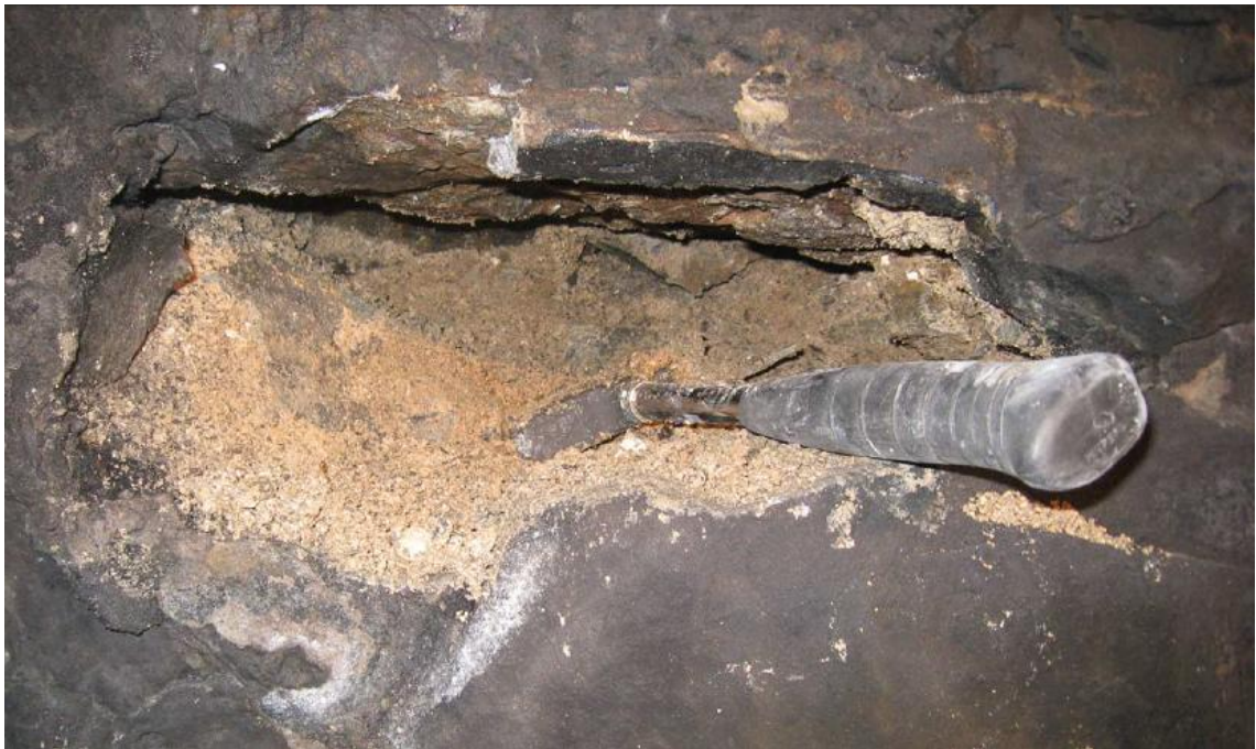
Obr. 2-6: Pohled na dutinu v ostění s degradovanou maltou [13]
