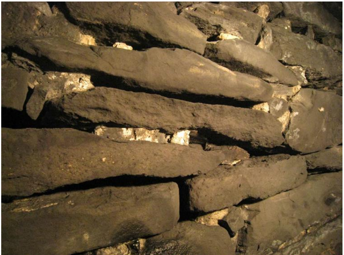
Obr. 2-5: Detail chybějícího spárování [13]
