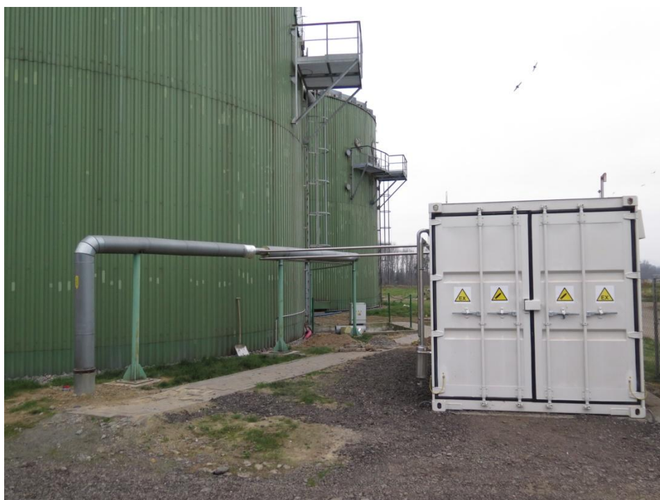
Obr. 3.11 Umístění výzkumného kontejneru a napojení permeátu na stávající potrubí bioplynu
