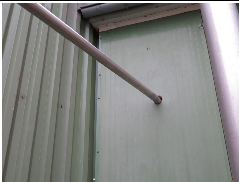
Obr. 3.10 Detail vyvedení přívodního potrubí ze strojovny fermentorů
