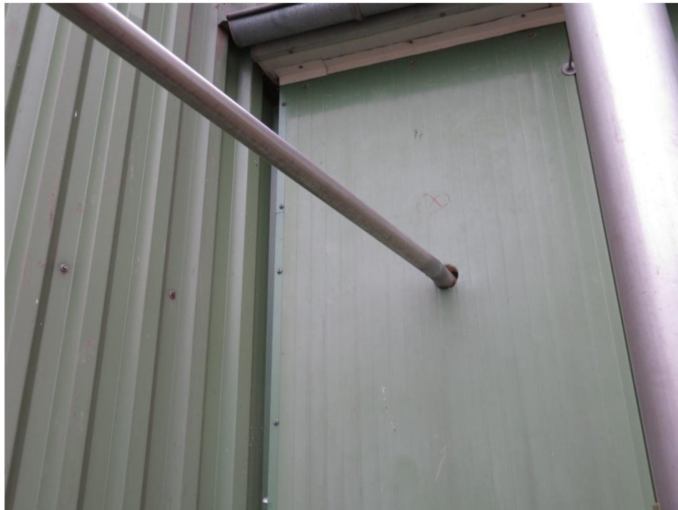
Obr. 3.10 Detail vyvedení přívodního potrubí ze strojovny fermentorů
