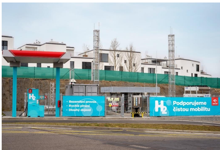
Obr. 17 Vodíková plnicí stanice na Barrandově [59]
