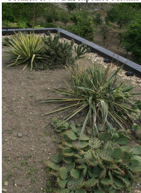
Obrázek č. 76: BZ, intenzivní střešní zahrada, 2012
