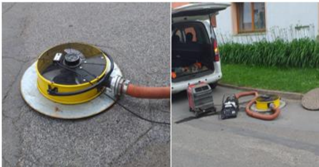
Obr. 27 - Technologie monitorování kanalizační stoky – vykuřováním (vlastní)
