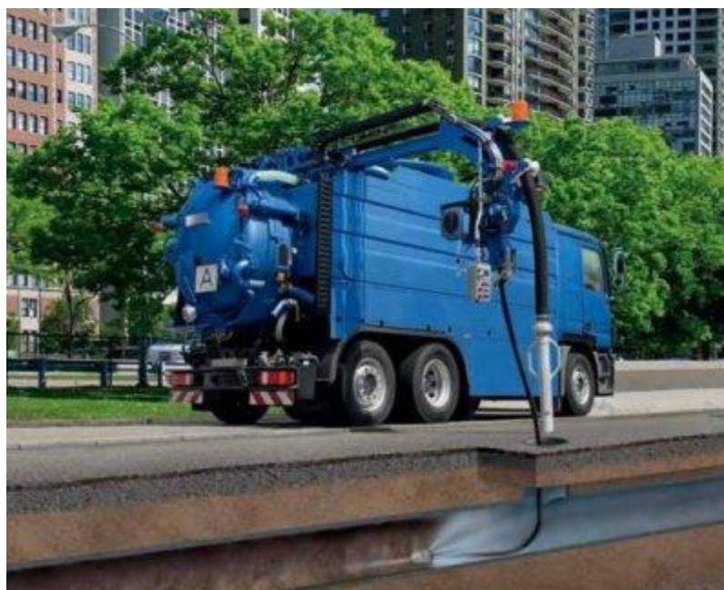
Obr. 26 - Kanalizačního vozidla s čerpadlem Uraca (Krajný, 2008)
