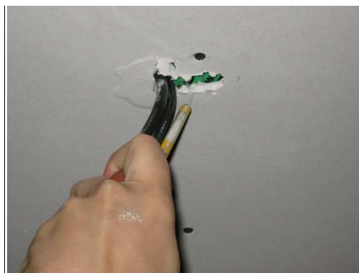
Obr. 16 Prostup elektroinstalačních kabelů
