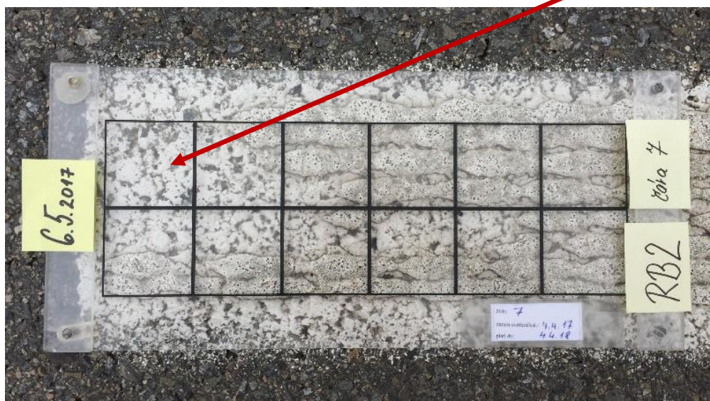
Vzorek RB2 s termoplastem – po 12 měsících – čára č. 8
